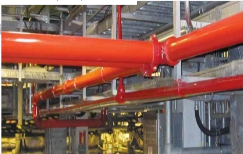
加強新消防系統設置
